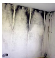
Schimmelpilze hinter einer isolierten Wandverkleidung.
